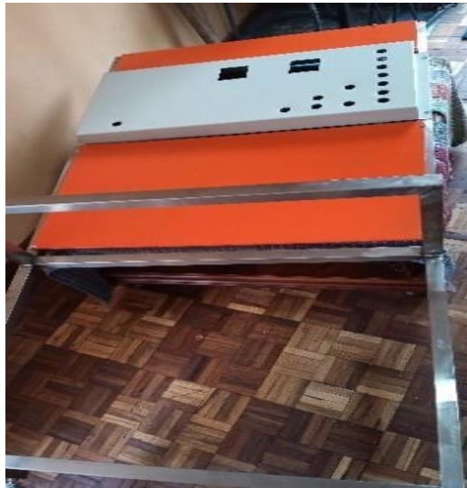
Figura 20. Tablero de control y fuerza empotradas en soporte de acero inoxidable
