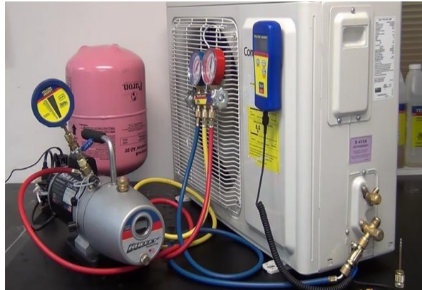
Figura 12. Proceso de carga sistema aire acondicionado
